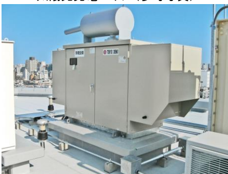
非常用発電機(参考写真)
