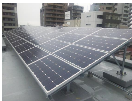
太陽光発電パネル(参考写真)
